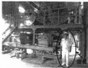
【写真】 旧し尿処理場の前処理設備
