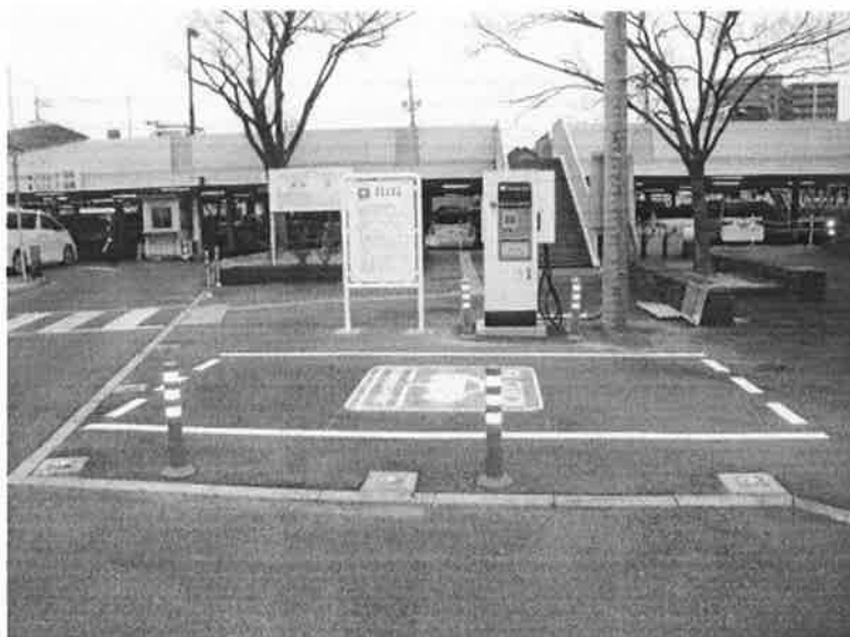
電気自動車用急速充電器(市役所本庁舎敷地)
