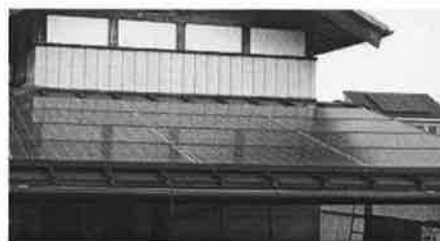
太陽光パネル設置例
